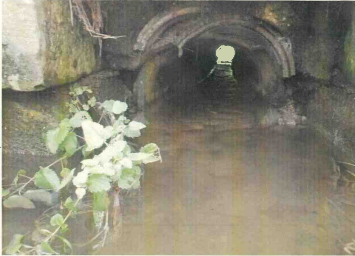
Photo N°6 Désordres (tuyaux cassés)
