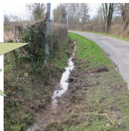
Fossé en eau
