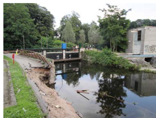
photo 10 : prise d'eau du canal d'aménagé de la centrale des acacias
