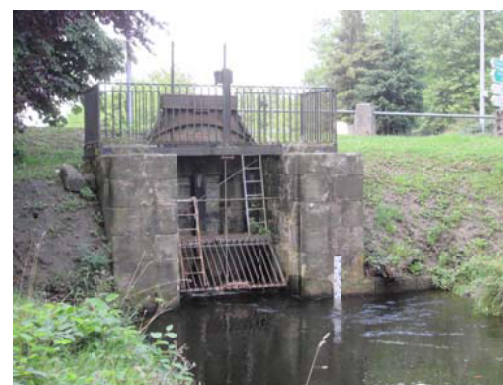
photo 26 : vanne de prise d'eau du canal des Vosges
